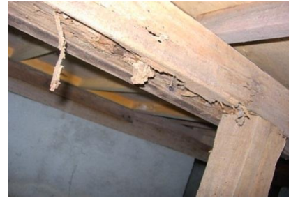
床下木部 大引きの被害
