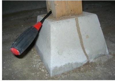
床下木部への侵入と束への被害
